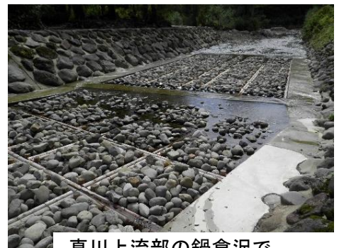
真川上流部の鍋倉沢で平成26年より施工されている流路工 令和3年度で完成
