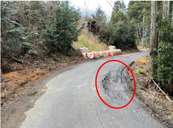
② 現地写真(R4年時点では修復済み)
