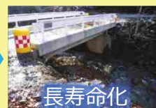
橋梁の老朽化
