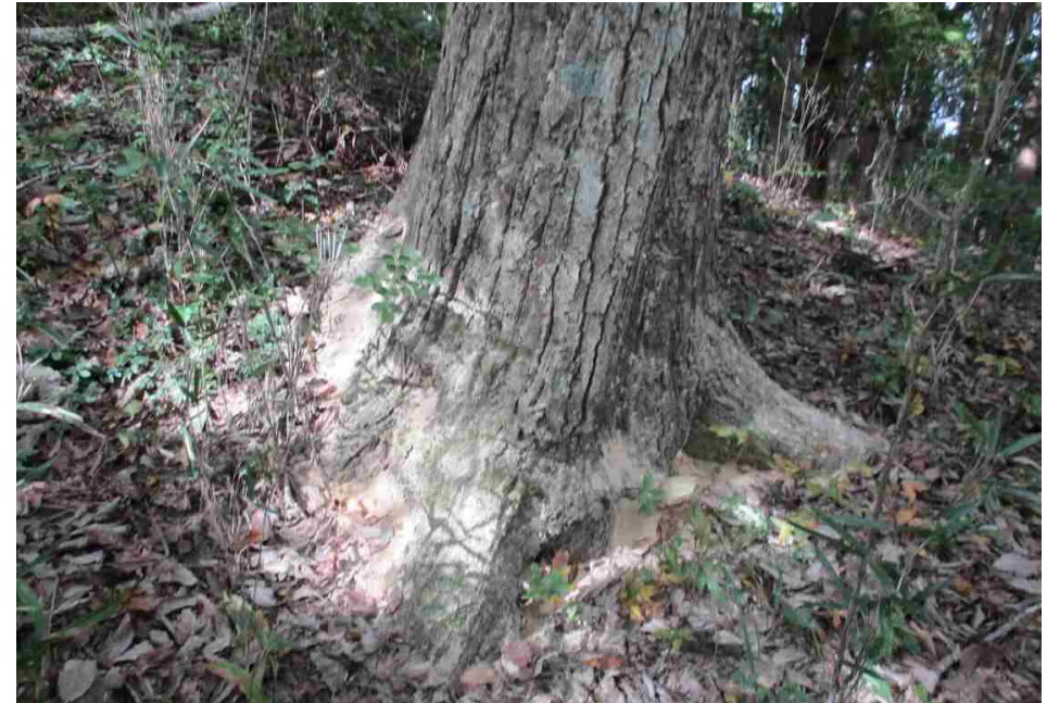
カシナガの穿入孔から大量にフラスが排出され根元付近に積もる。
