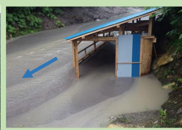
下流の天然温泉被災状況 (R3.8)
