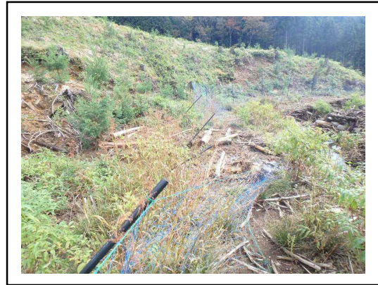
(写真－２) ドローンで撮影した柵 (大規模な破損箇所)
