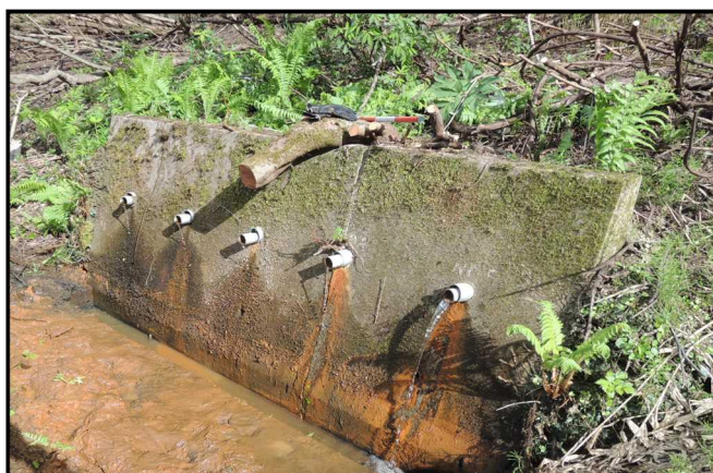
図1 集水状況のバラツキ
