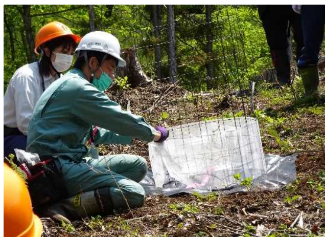
単木柵設置 その2 (ウサギ等小動物の侵入防止対策として 単木柵下部寒冷紗巻付け作業)
