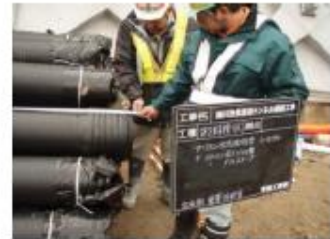
施工計画書に基づき 計画的に臨場確認 「取りあえず」の場当たりの 臨場確認は行わないこと
