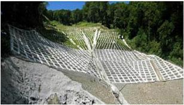
治山事業による崩壊地の復旧 (みなかみ町)
