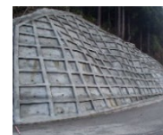
幹線林道のり面保全
