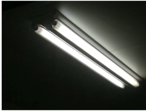
図3 蛍光灯カバーによる飛散防止
