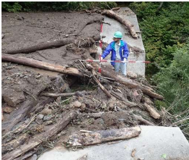
治山ダムが土砂・流木を捕捉し、下流の民家等への流出を抑制
