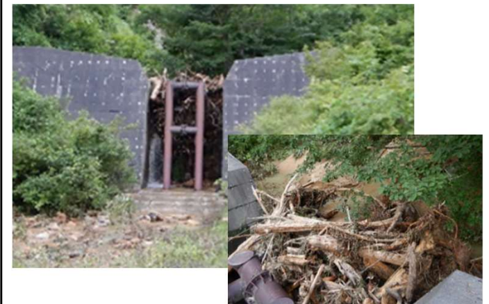
流木捕捉式治山ダムが流木を捕捉し、下流への流出が抑制され、集落や国道等への被害を防止
