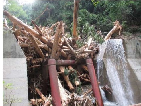
流木の捕捉状況（徳島県）
