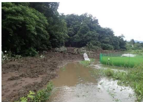
応急対策工事前
