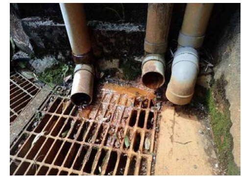
・水抜き孔からの湧水により常時湿っている（鉄分を含むことを示唆する赤褐色物質が沈積）
