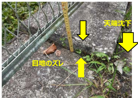
・擁壁目地にズレが生じ、盛土地盤（天端の舗装）が沈下している
