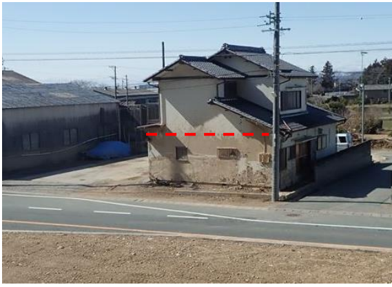
家屋の被害状況（2m程度の土砂痕跡）
