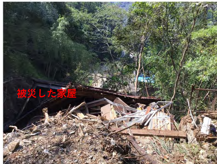
松の越③ 建物被災状況
