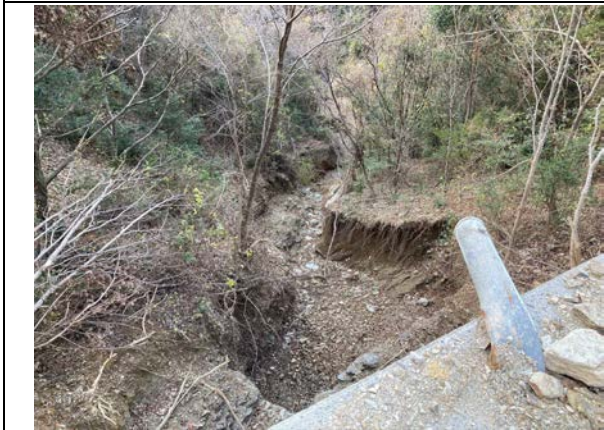
溪床内侵食状況と破損したガードレール
