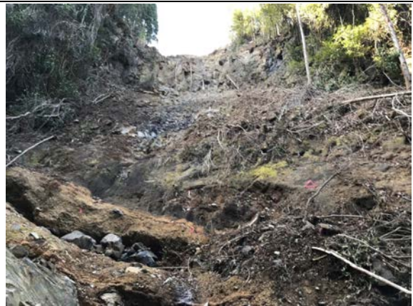
崩壊地中部の露岩状況
