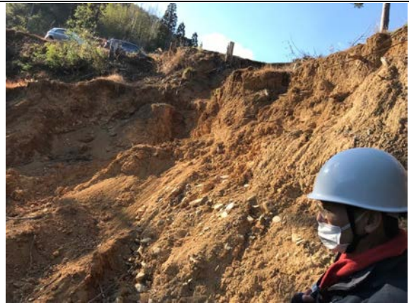
崩壊地頭部の斜面状況
