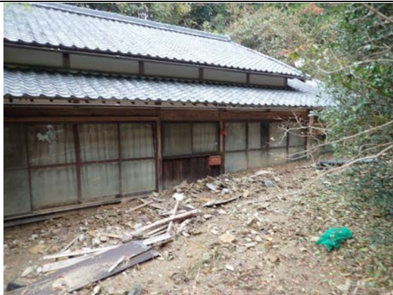
家屋Bの周辺に堆積する土砂（損傷なし）
