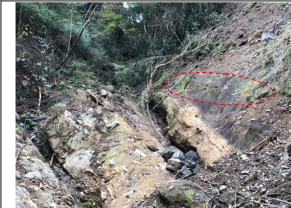
崩壊地下端の洗掘状況（苔）
