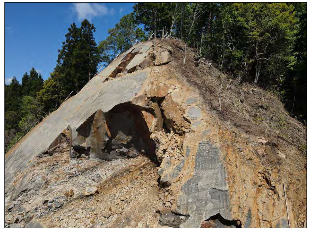
④斜面中部の崩壊（2m程度オーバーハング）
