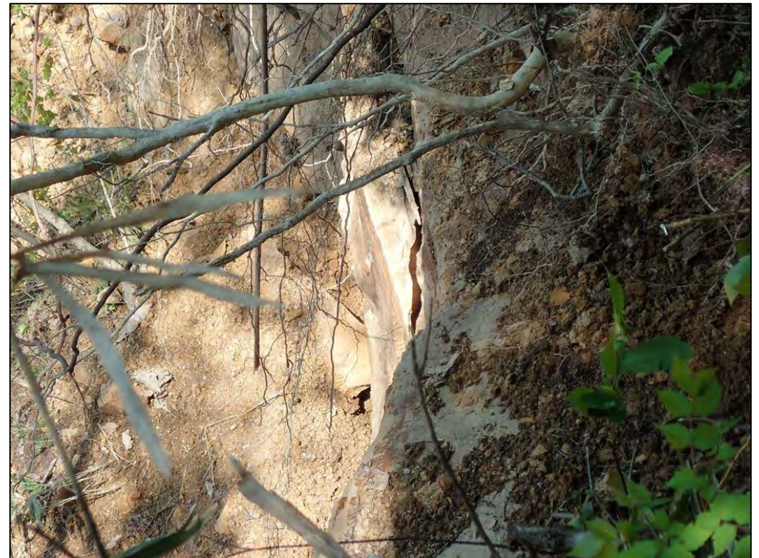
④崩壊地頭部の亀裂
