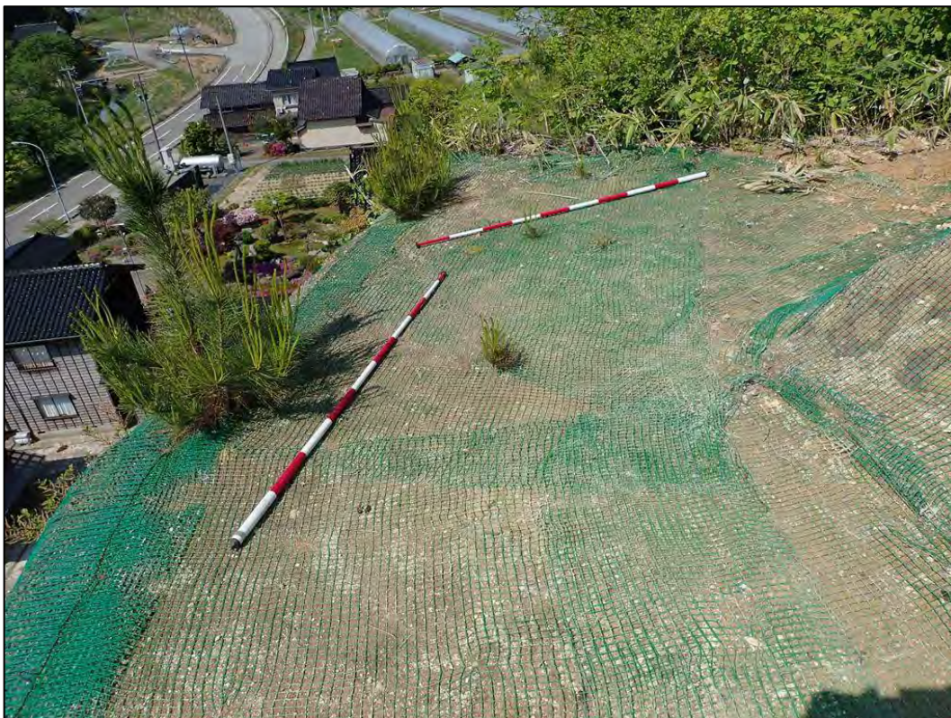
⑦切土斜面の亀裂
