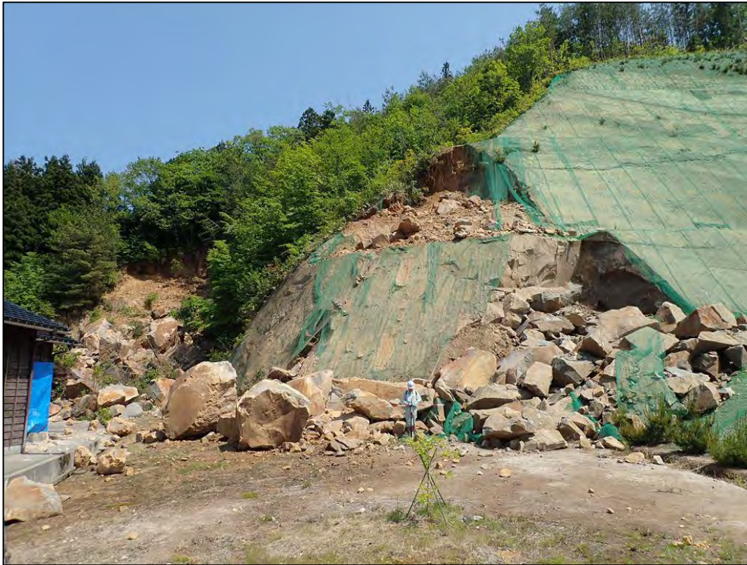
①崩壊地全景
