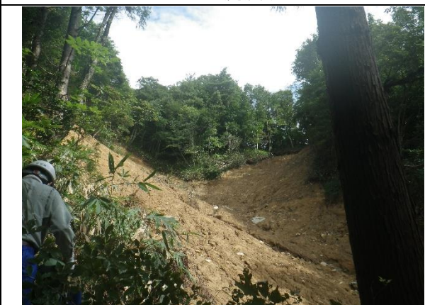
大規模崩壊地
