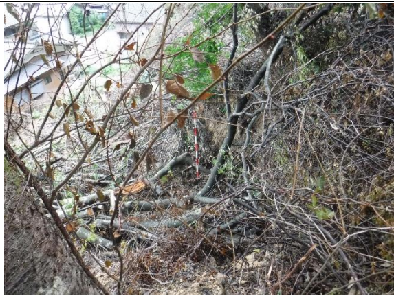
下部の小崩壊（崩壊深 2m）
