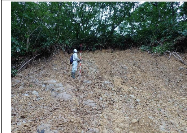
崩壊地頭部の状況
