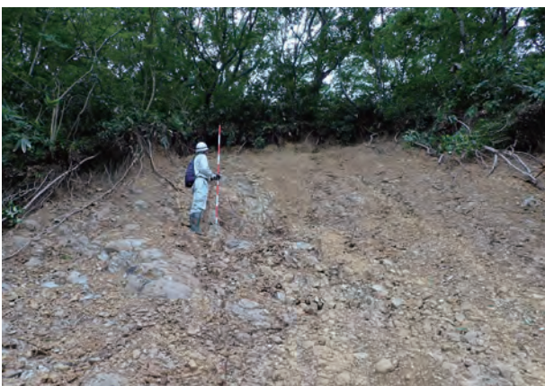
崩壊地頭部の状況
