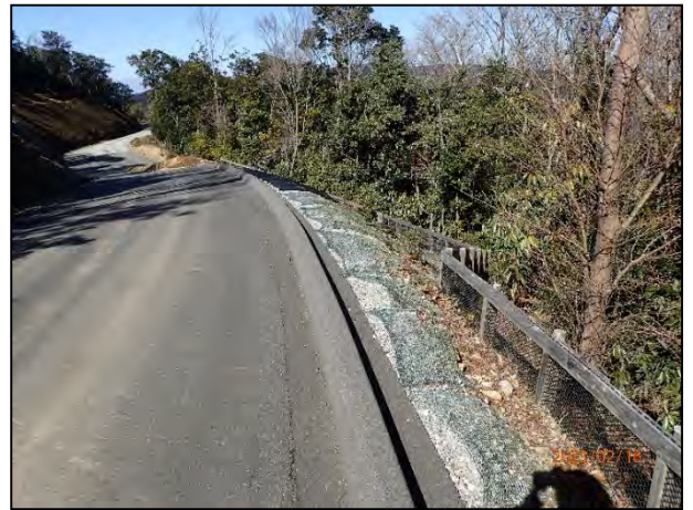
写真 7-24 4号機に至る林道沿いの法面とそれに平行して設置されている編柵工
