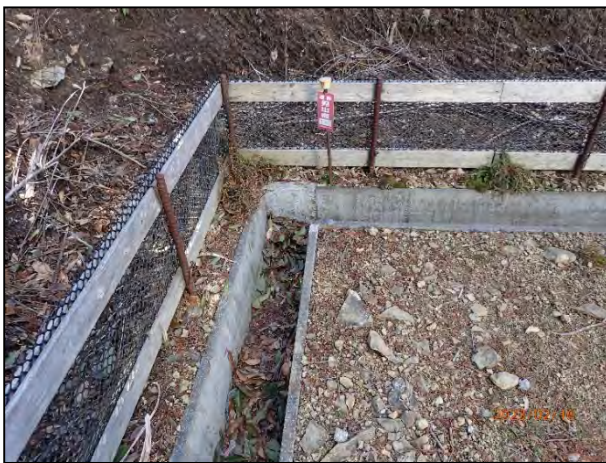
写真 7-41 7号機ヤード切土法面下部に設置された編柵工と開渠水路の土砂堆積状況
