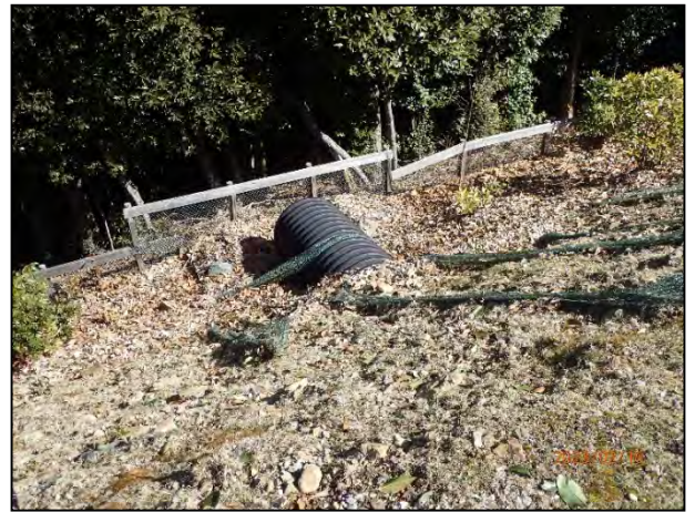
写真 7-14 3号機の集水柵越流水の排水を処理するためのかご枠、編柵工設置状況
