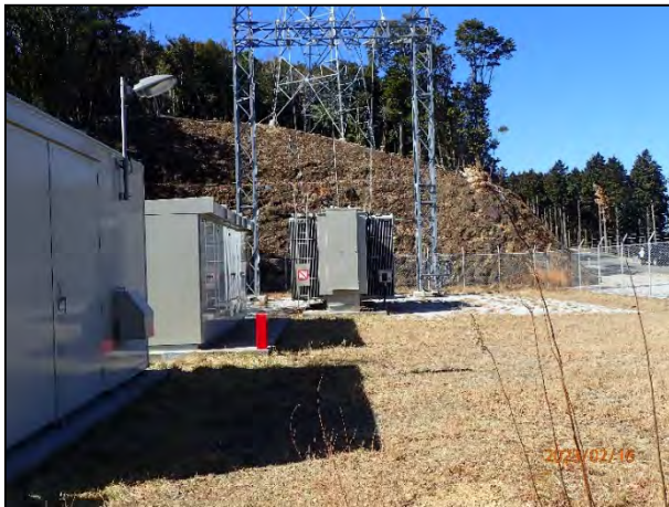
写真 7-51 変電所のヤード内の変電器、送電線等 の施設の設置状況
