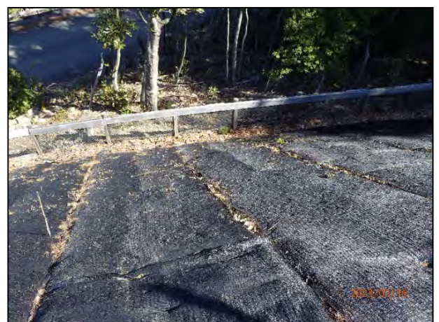
写真 7-54 変電所への進入路南側法面の寒冷紗に よる養生及びその下流の編柵工
