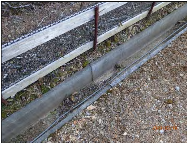
写真 7-23 4号機のヤード切土法面沿いの編柵工及びヤード末端の開渠水路の状況
