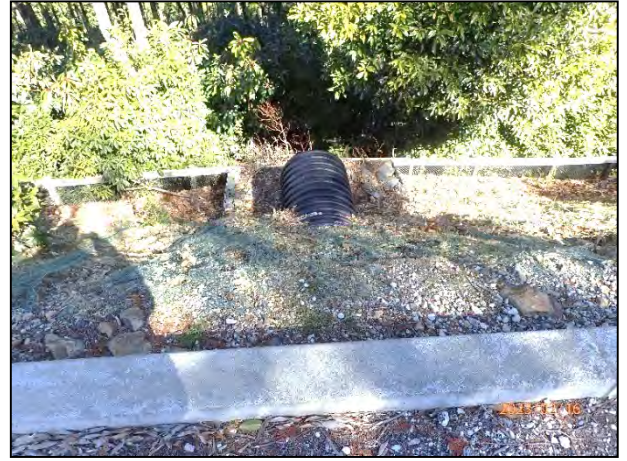
写真 7-38 7号機の集水柵越流水の排水を処理するためのかご枠、編柵工設置状況
