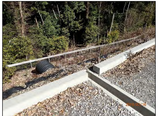
写真 7-32 6号機の集水枡越流水の排水を処理するためのかご枠、編柵工設置状況
