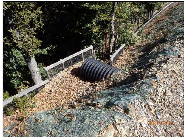
写真 7-2 1号機の集水枡越流水の排水を処理するためのかご枠、編柵工設置状況
