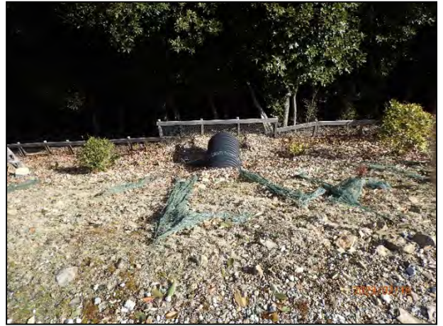
写真 7-26 5号機の集水枡越流水の排水を処理するためのかご枠、編柵工設置状況
