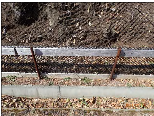
写真 7-5 1号機ヤード切土法面下部に設置された編柵工の土砂堆積状況
