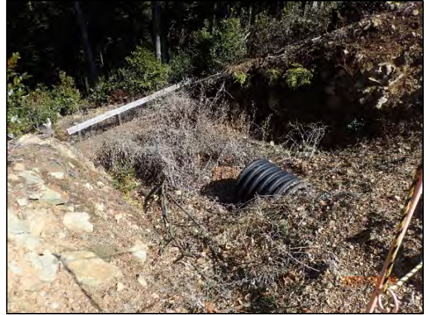
写真 7-8 2号機の集水柵越流水の排水を処理するためのかご枠、編柵工設置状況
