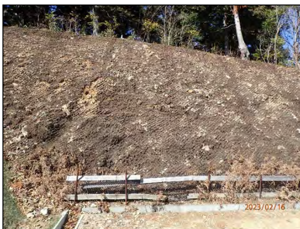
写真 7-17 3号機ヤード切土法面、下部に設置された編柵工の土砂堆積状況
