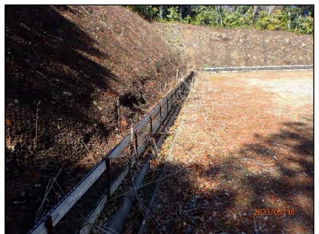
写真 7-34 6号機ヤードの切り取り法面、編柵工及び開渠水路の状況
