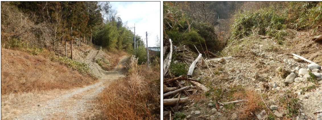
写真 5.10 事例(2)詳細:パネル群間の谷から土砂が発生し下部の道路に流出 太陽光発電施設間の谷から土砂が流出し、下流の保全対象に悪影響を与えた事例。太陽光発電施設区域に土砂流出等の傾向は全くない。
