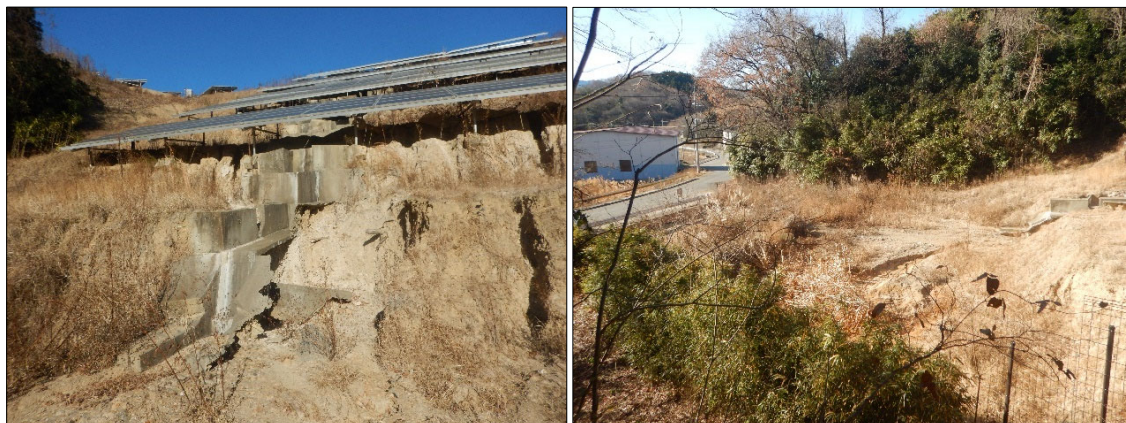
写真 5.2 盛土面の侵食(対応としてコンクリート水路施工)と沈砂池の埋没
