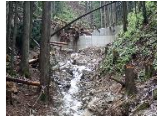
岐阜県下呂市 (令和2年7月豪雨の際に効果を発揮した治山ダム)
