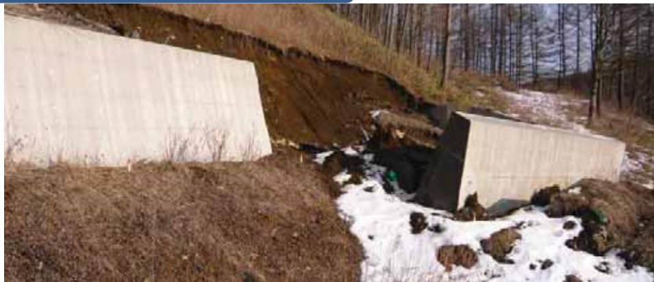
《対策実施前（損傷状況）》
