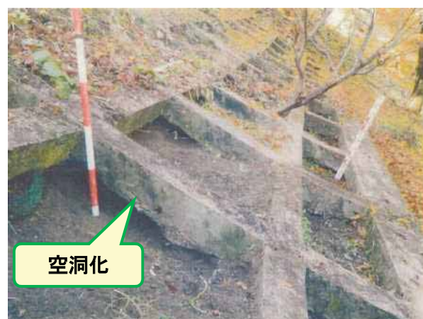
《対策実施前（損傷状況）》
