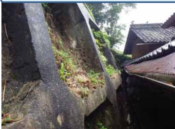
《対策実施前（損傷状況）》
