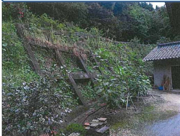
《対策実施前（損傷状況）》
