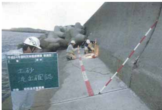
防潮堤基礎部の空洞確認状況
