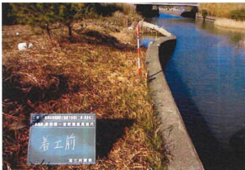
《対策実施前（損傷状況）》
