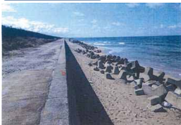
《対策実施前（損傷状況）》
