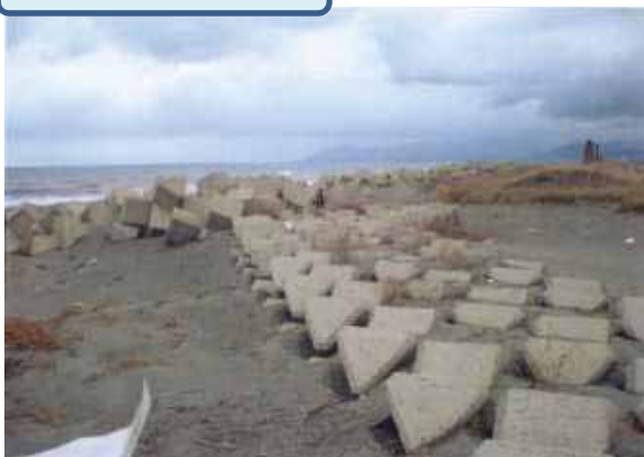
《対策実施前（損傷状況）》
