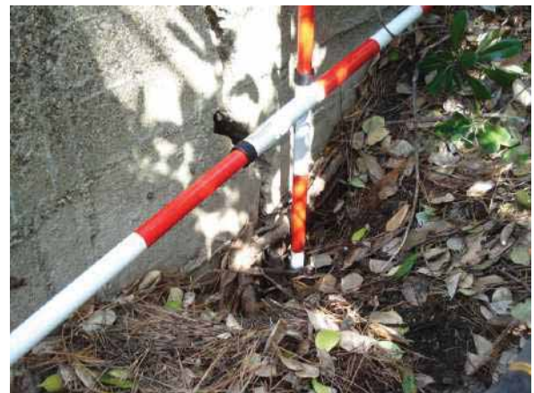
背面沈下状況（クラックからの土砂拔出）
