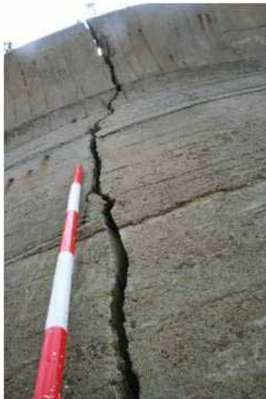
クラック発生状況
