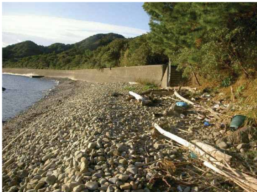
防潮堤の堤体コンクリートの剥離
