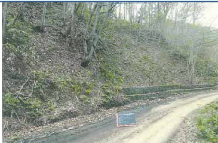
《対策実施前（損傷状況）》
