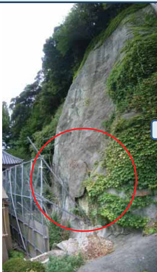
《対策実施前（損傷状況）》
