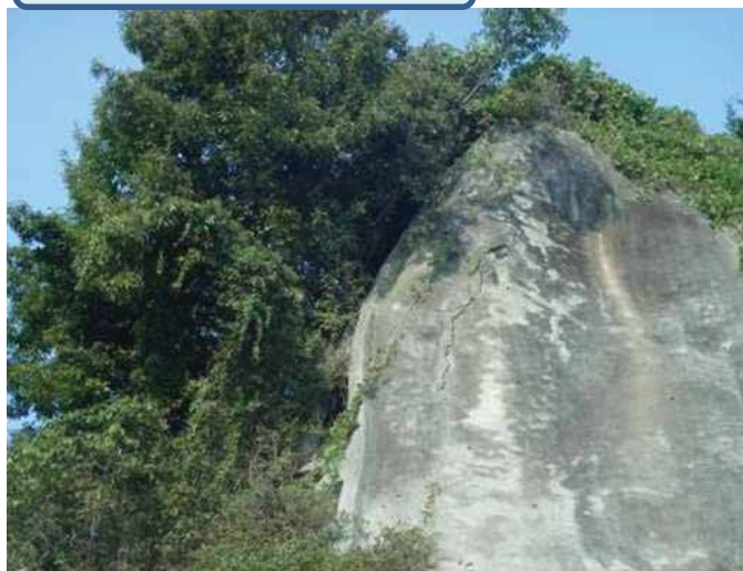
《対策実施前（損傷状況）》
