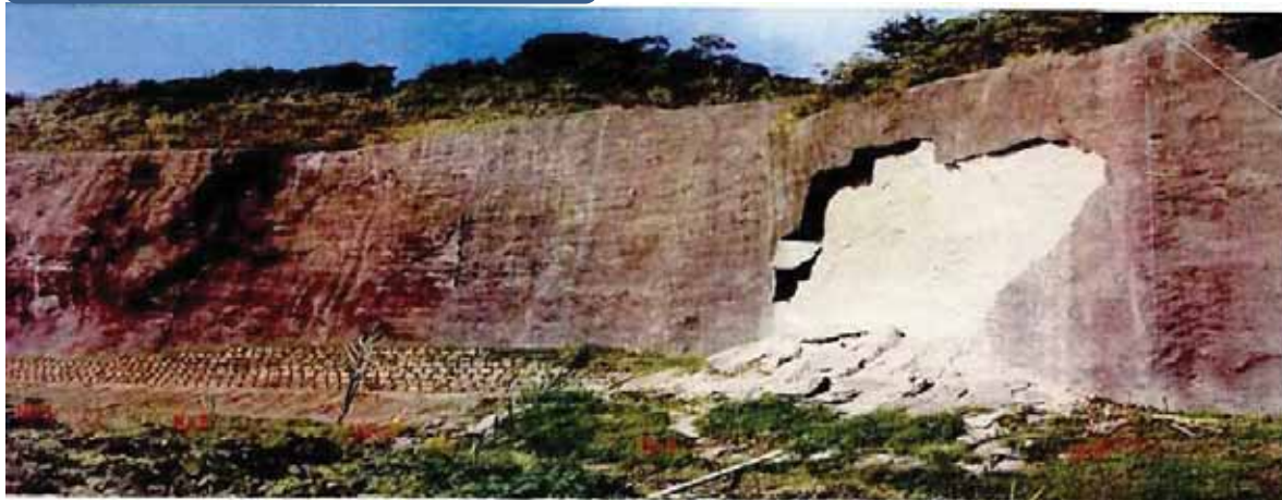
《対策実施前（損傷状況）》
