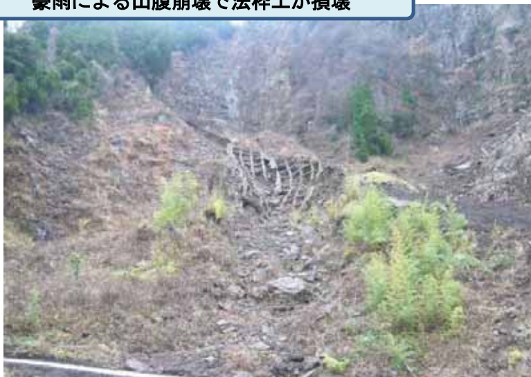
《対策実施前（損傷状況）》
