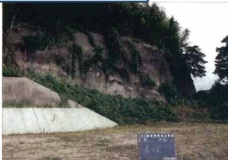
《対策実施前（損傷状況）》
