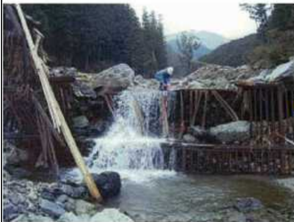
堤体破損、中詰材流出 損傷状況
