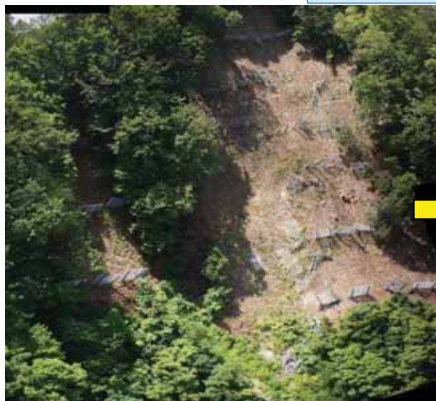
《対策実施前（損傷状況）》
