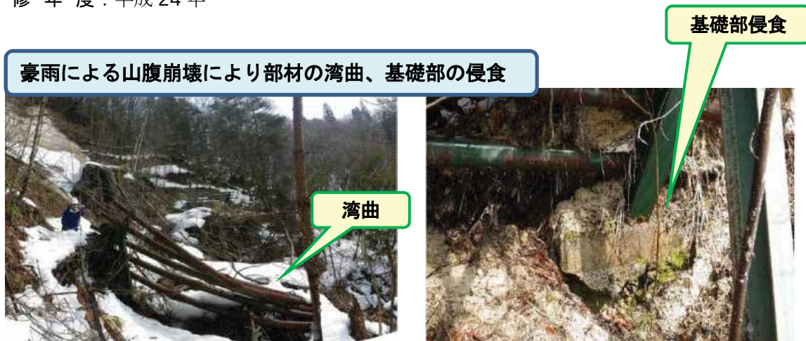
《対策実施前（損傷状況）》
