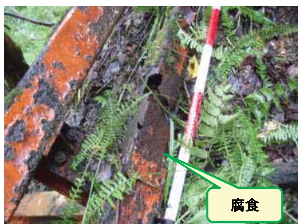
《対策実施前（損傷状況）》
