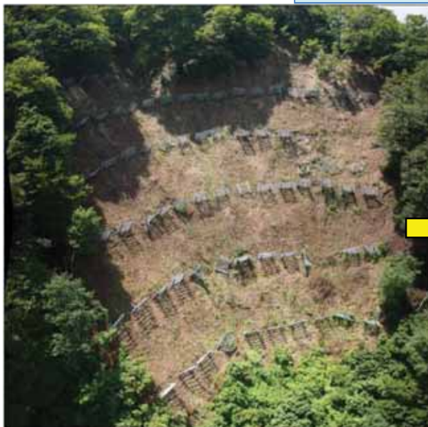
《対策実施前（損傷状況）》
