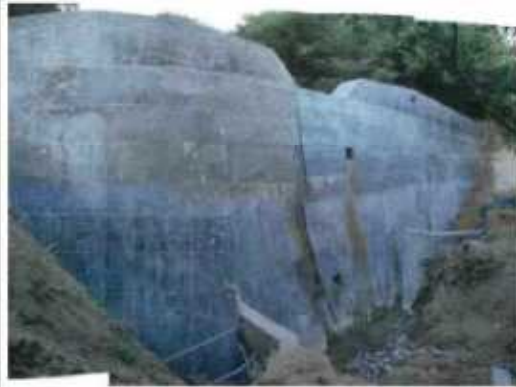
既設谷止工 損傷状況
