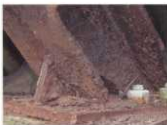
脚部の腐食が顕著な状態
