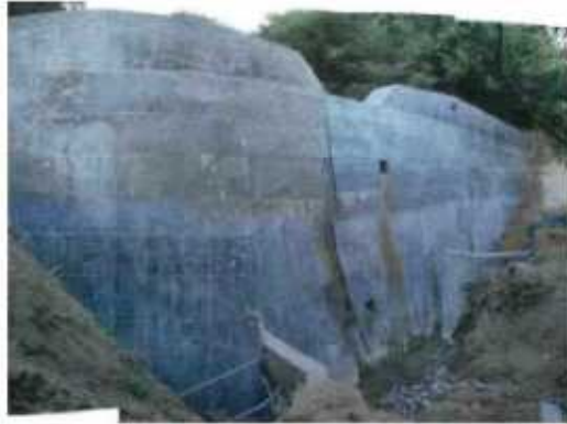
既設谷止工 損傷状況
