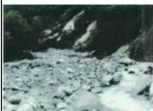
破損状況及び周囲の状況
