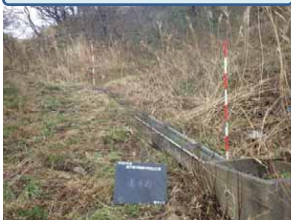
《対策実施前（損傷状況）》
