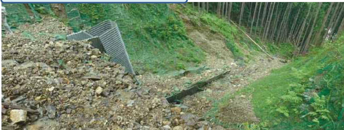
《対策実施前（損傷状況）》
