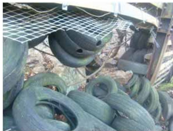
《対策実施前（損傷状況）》
