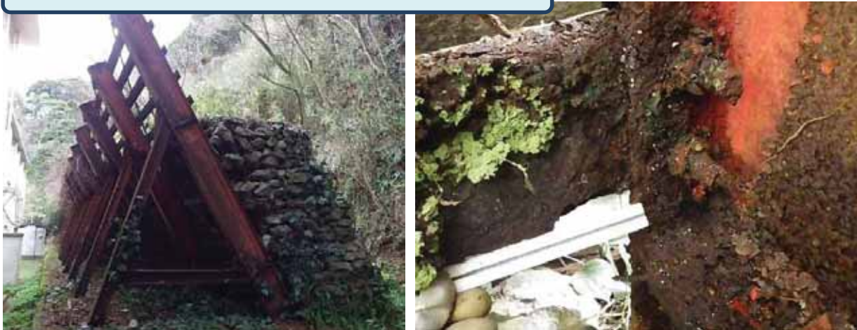
《対策実施前（損傷状況）》
