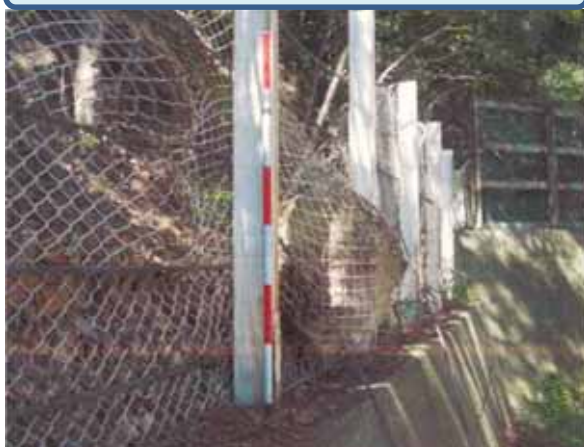
《対策実施前（損傷状況）》
