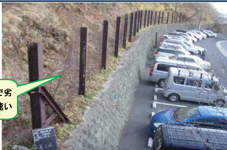
《対策実施前（損傷状況）》
