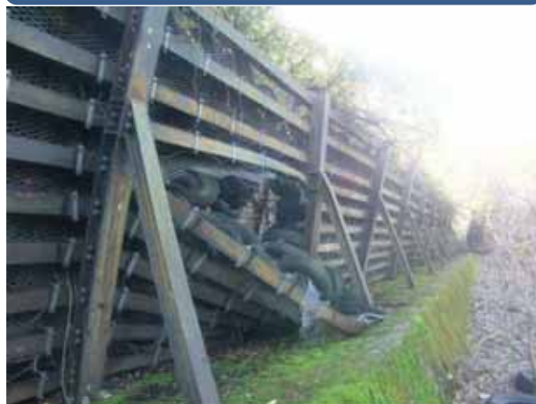
《対策実施前（損傷状況）》
