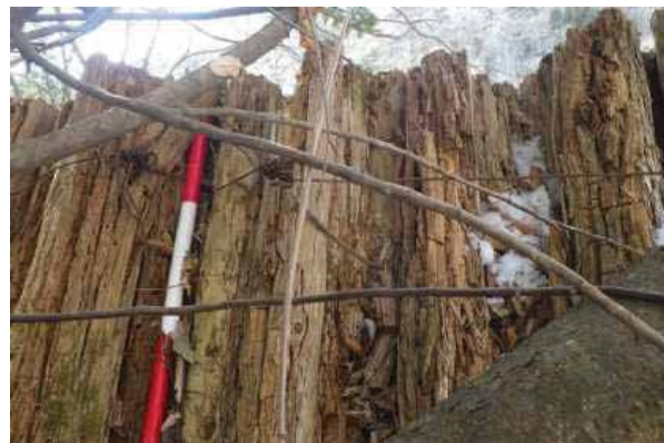
《対策実施前（損傷状況）》
