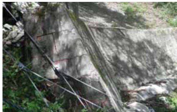
《対策実施前（損傷状況・拡大）》
