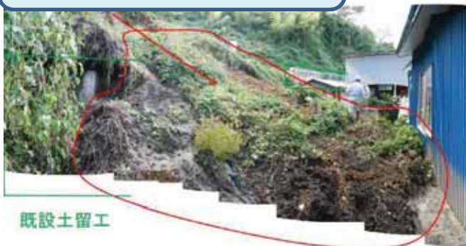
《対策実施前（損傷状況）》
