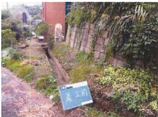
《対策実施前（損傷状況）》
