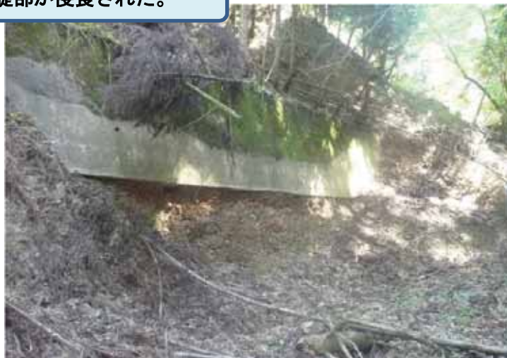
《対策実施前（損傷状況）》
