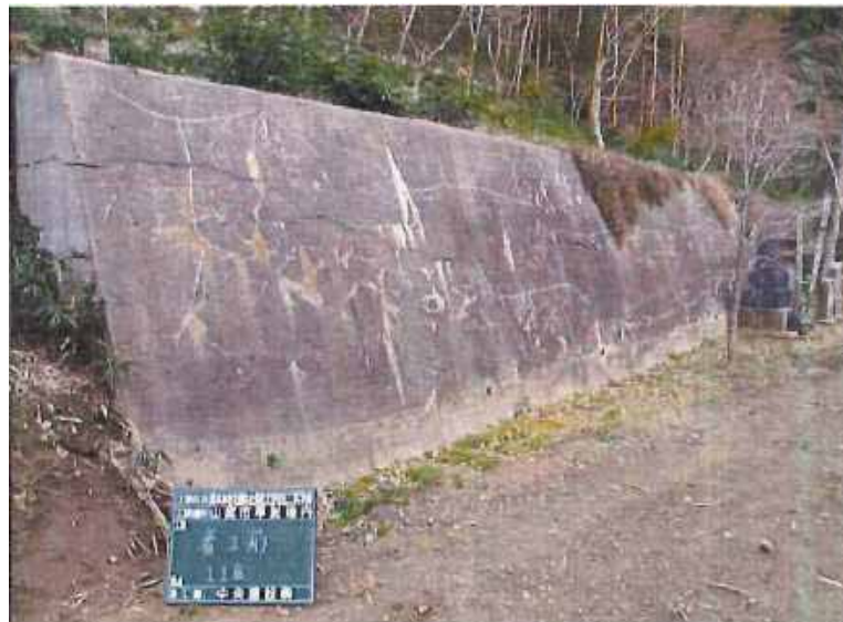
《対策実施前（損傷状況）》
