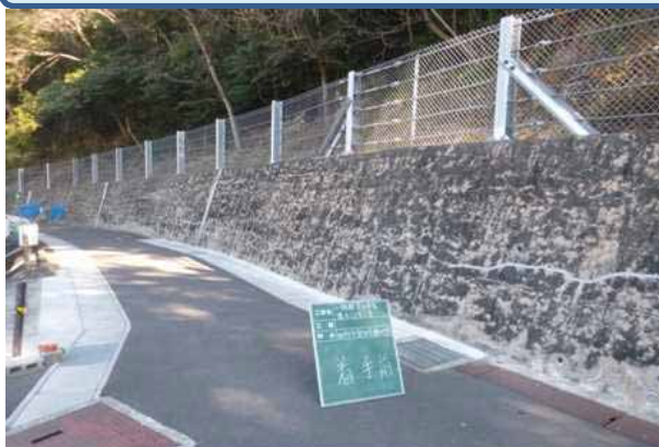
《対策実施前（損傷状況）》
