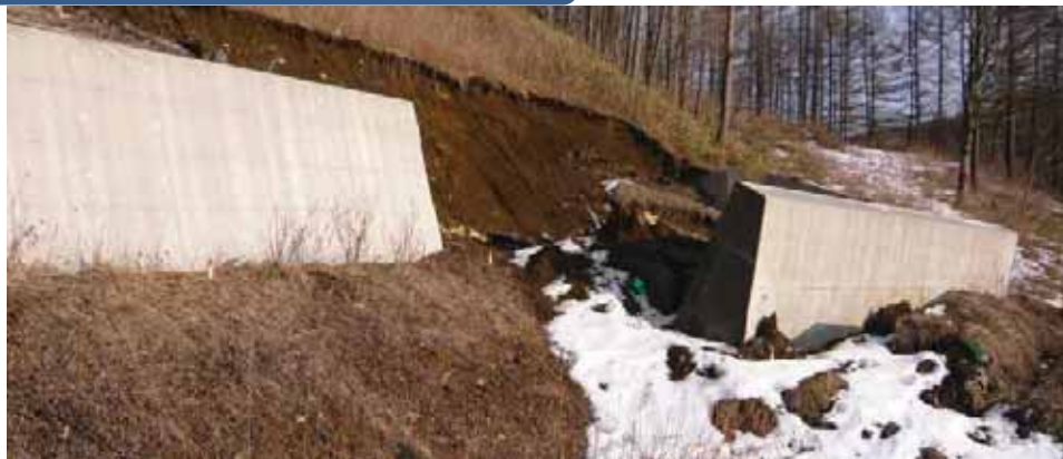
《対策実施前（損傷状況）》
