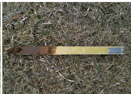
写真-9 29年後に確認した木杭
