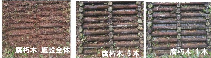
写真-7 10年経過後の木材の状況 (左: 無処理、中: 加圧のみ、右: 圧縮+加圧)
