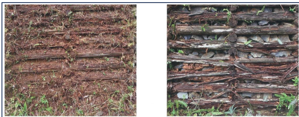
写真 3-4 無処理木材の状況 (左：中詰材が土砂 右：中詰材が栗石)
