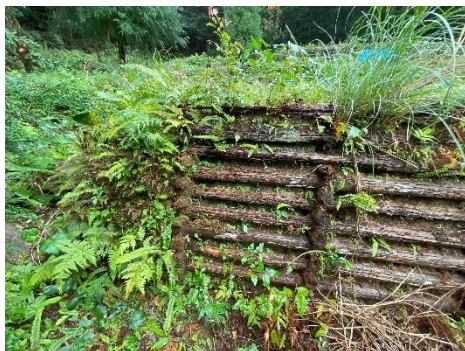
写真 3-9 無処理木材の状況
