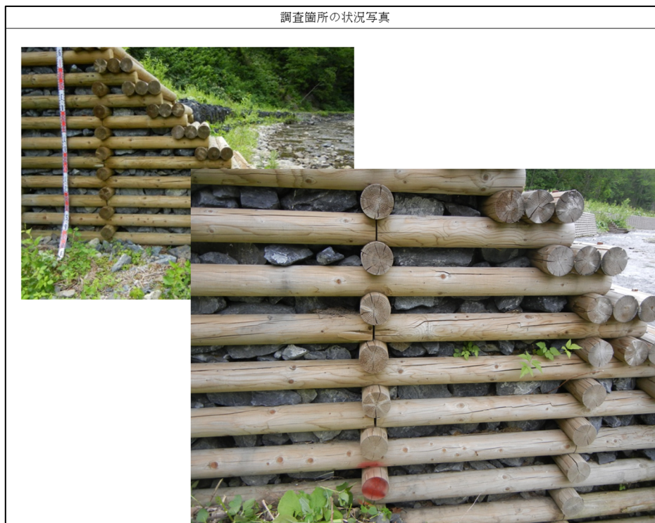
図 3-8 変化の小さかった施設の事例 1（工種：治山ダム 防腐処理：ACQ）
