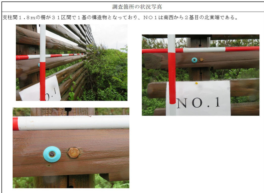
図 3-10 変化の小さかった施設の事例 3 (工種：防風柵 防腐処理：ACQ)
