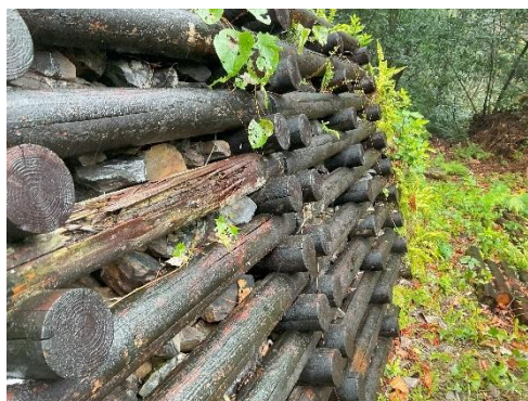
写真 3-12 腐朽した部材の近景
