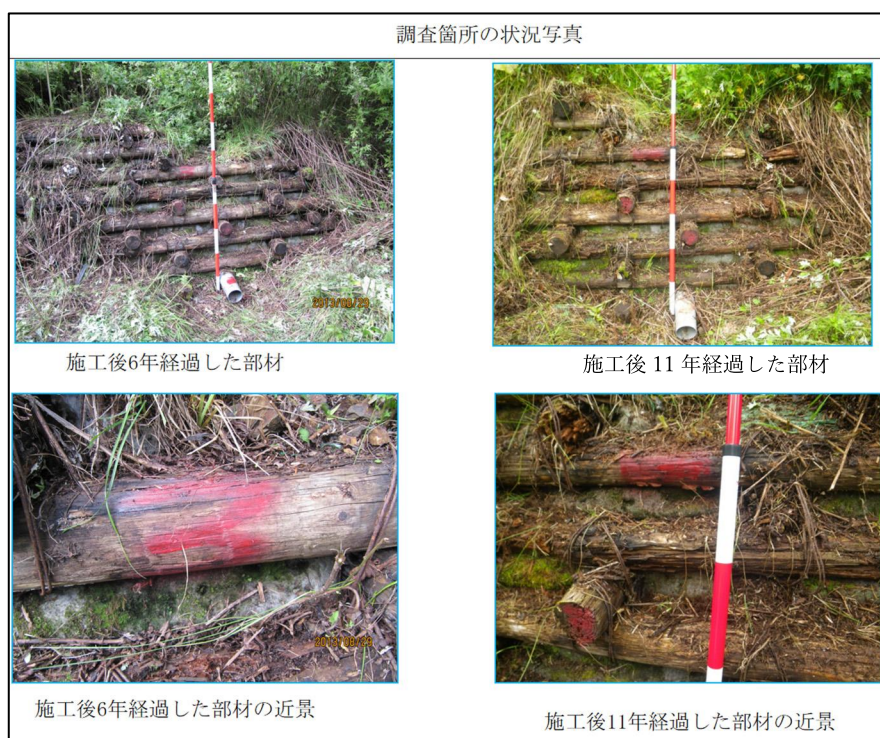
図 3-6 変化の大きかった施設の事例 1 (工種：土留工 防腐処理：無し)
