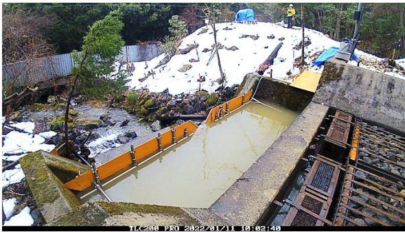
図 4.44 1月11日 10:00 取水栓は濁水化し、沈砂池の濁水は希釈され緩和。
