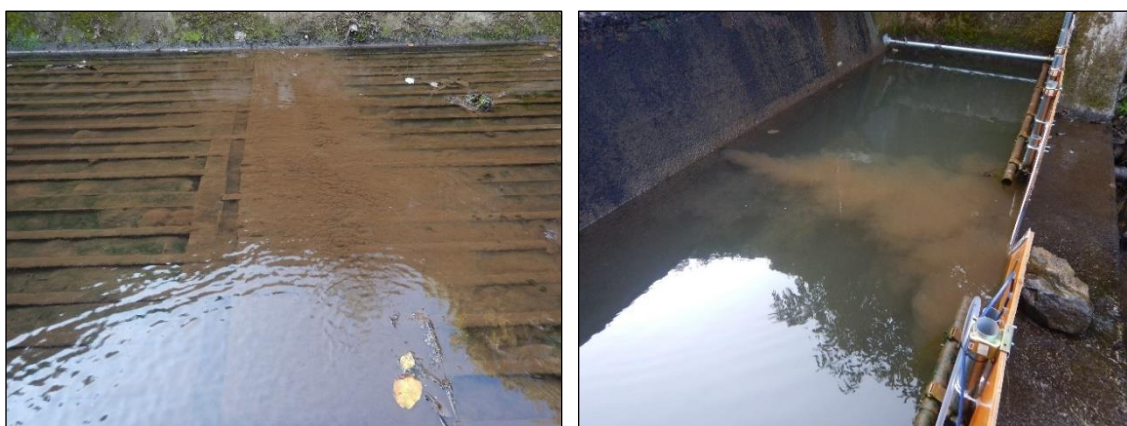
図 6.1 施設機能復元前の水質保全施設及び取水柵の濁質移動状況
