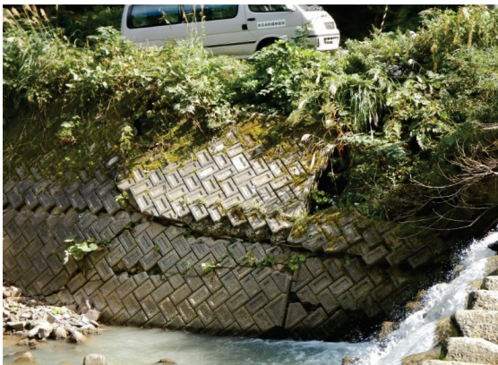
④ 護岸工に生じた変状
