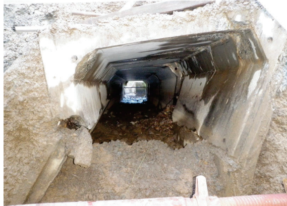
⑤ 市道横断水路工に生じた変状
