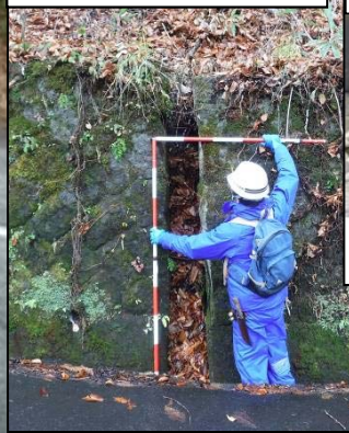
国道103号 擁壁隙間
