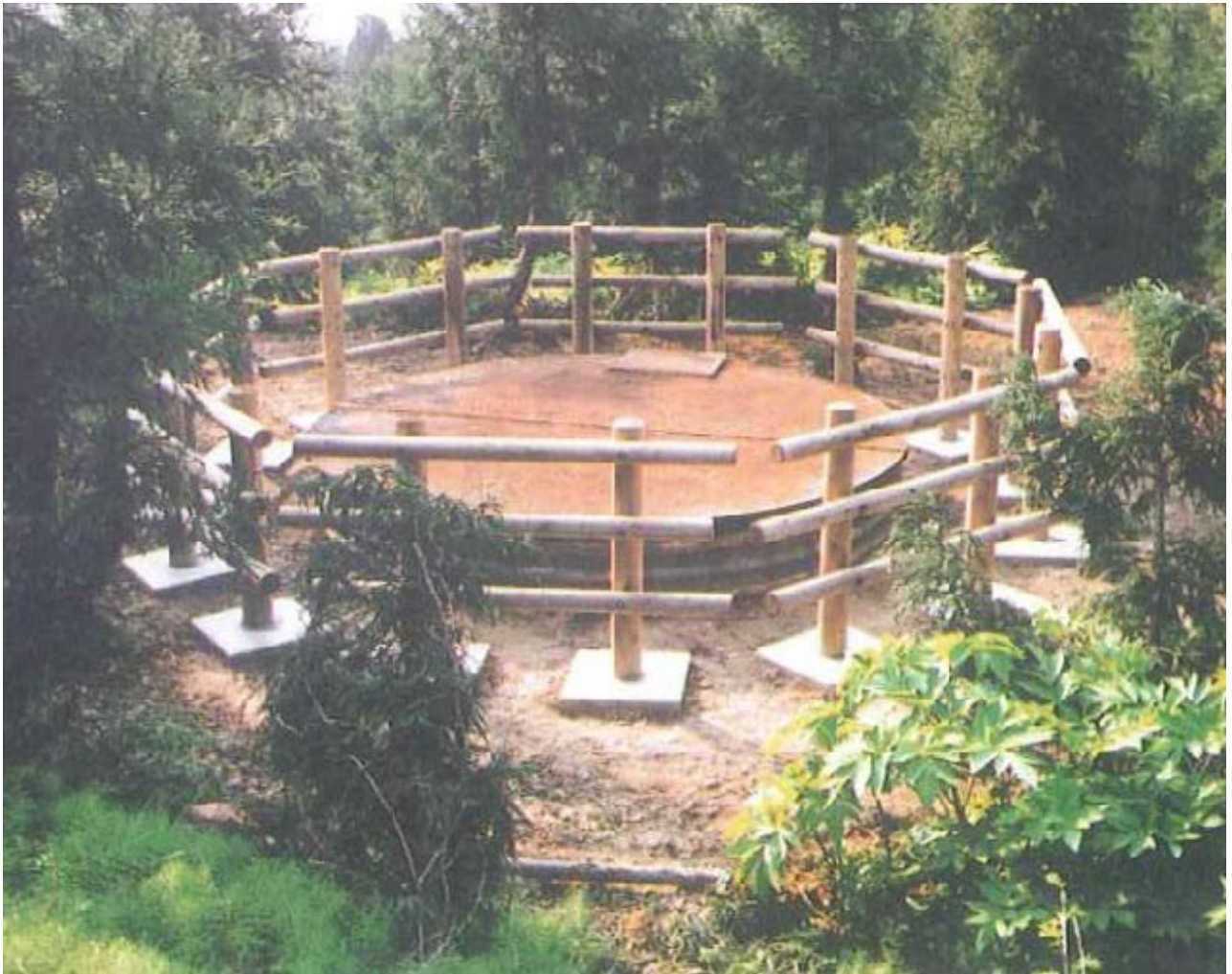
集水井用安全柵工 平成 11 年度施工／スギ間伐材 1.02 m 3 使用
