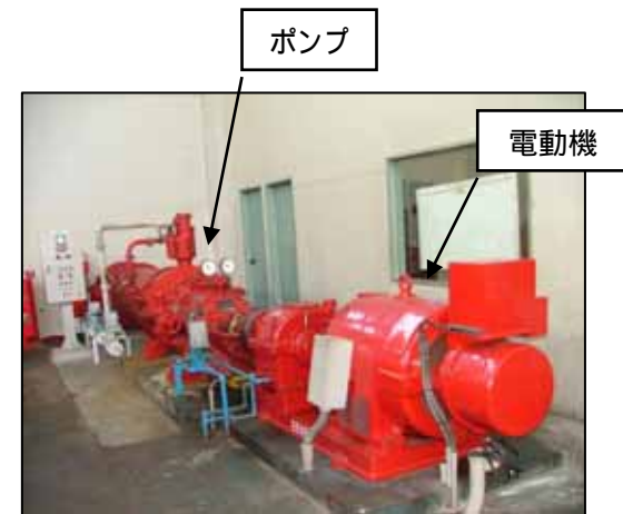
更新前のポンプ
