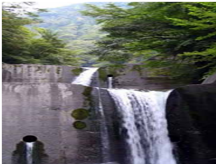
既設治山ダムの放水路摩耗 (放水路 中央部が摩耗している状況)
