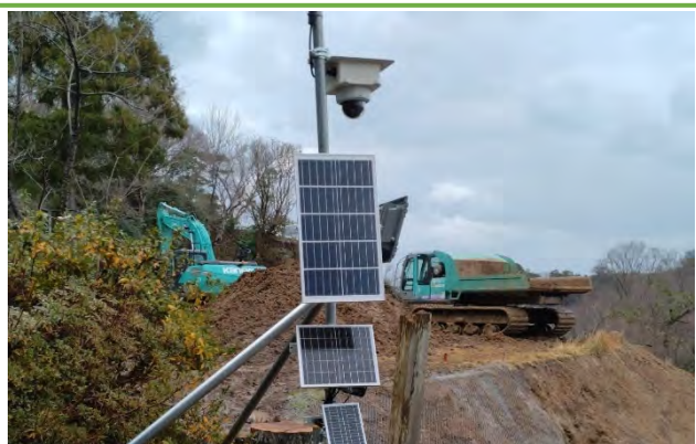
監視カメラ（PTZカメラ）設置状況
