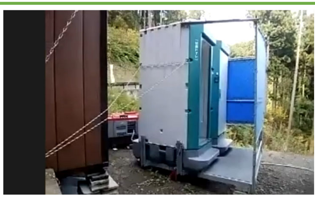
快適トイレ設置状況の遠隔確認
