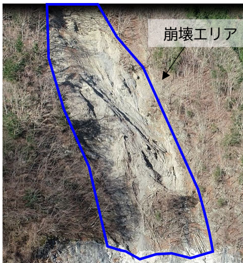
UAV撮影による斜面崩壊状況の把握
