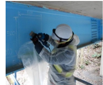
塗膜の部分剥離
