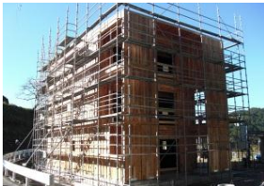
CLTの施工方法の確立及びコストダウンに向けたCLTを活用した先駆的建築の支援
