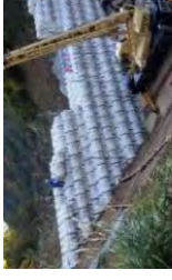
地すべり防止施設
