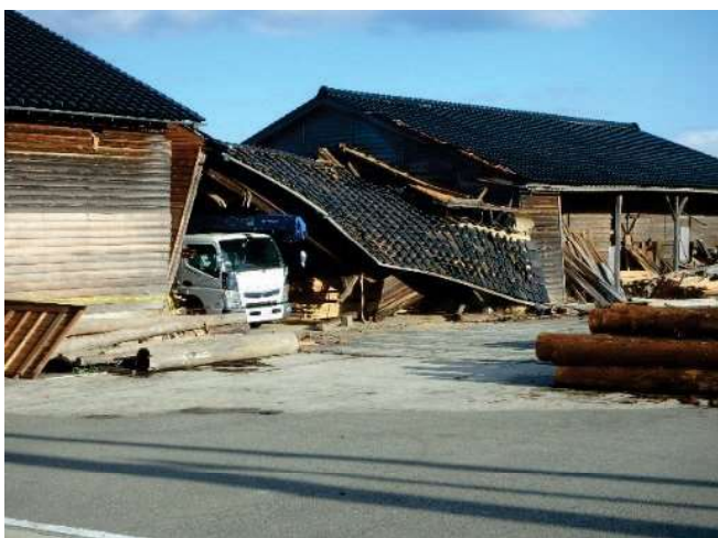
木材保管庫の倒壊（七尾市）
