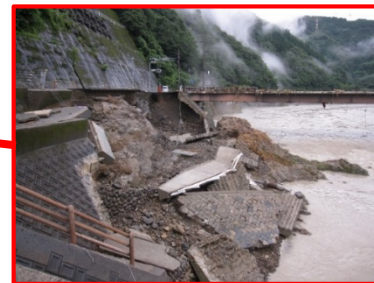
国道219号線の被災状況（球磨橋付近）
