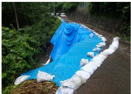
町道砂ヶ瀬線の被災状況
