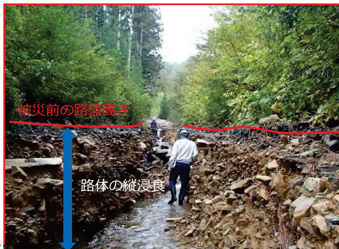
【岩手県下閉伊郡山田町 島田線】 雨水等による路体の著しい縦浸食
