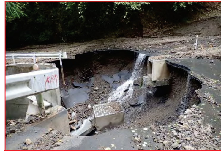
【埼玉県秩父郡小鹿野町 皆本沼里線】 沢部からの異常出水により路体が損壊
