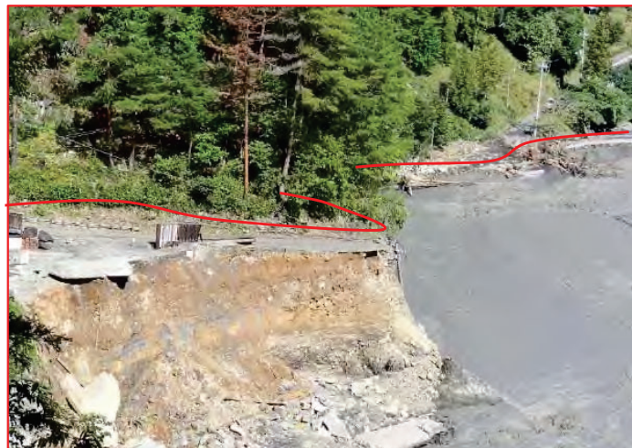
【山梨県南巨摩郡早川町 井川雨畑線】 河川の増水により、路体が流失
