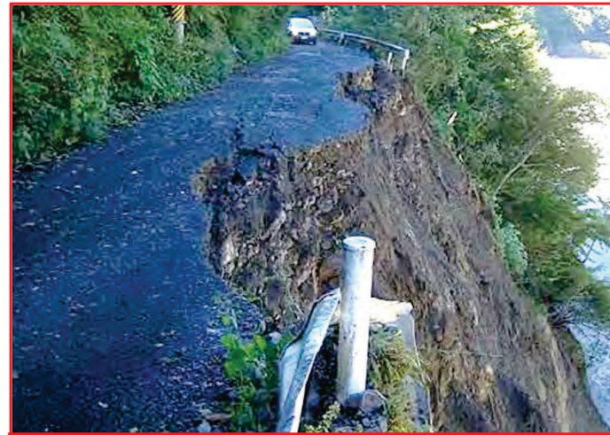
【静岡県静岡市 東俣線】 河川の増水により、路体が決壊し路体も流失
