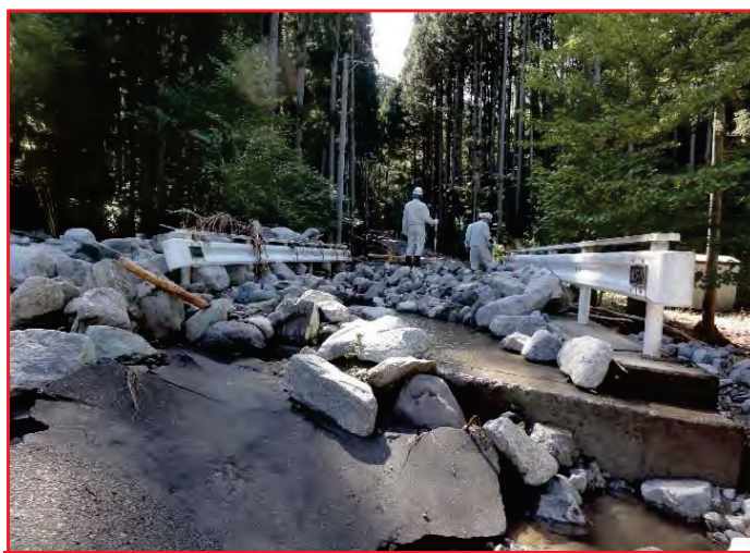
【福島県相馬市 坂下新宿線】 土石流により橋梁が被災
