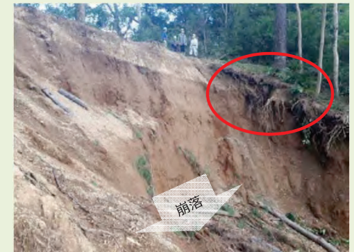
【損壊した試験林】 周囲の樹木の根が浮いた状態であり、今後さらに被害が拡大する恐れ。
